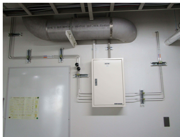
図3. C棟廊下に増設された各種ガス配管
