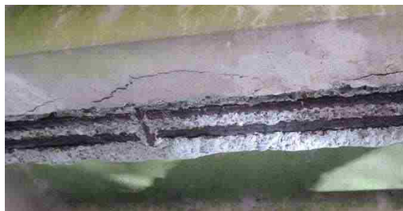
図 1. 塩害が発生した橋梁
